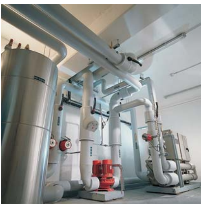
Применение в насосных агрегатах
